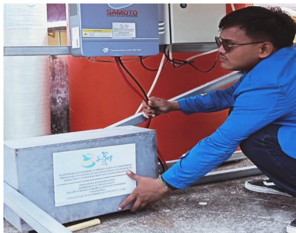
Gambar 4. 4 Instalasi Baterai LiFePo4
