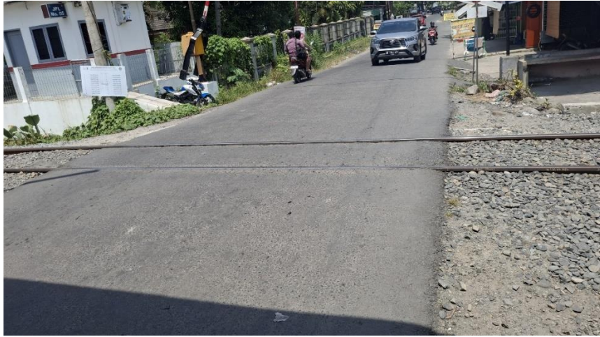
Gambar 4.3: Kondisi Perkerasan Jalan (Sumber Dokumen Penulis)
