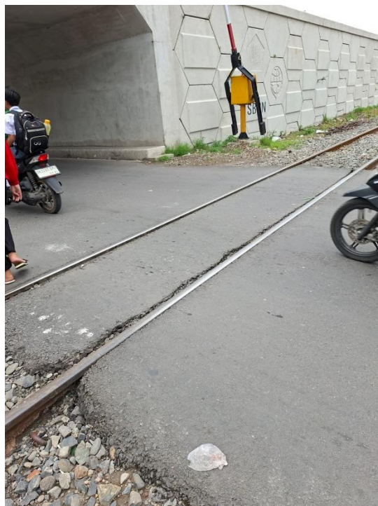
Gambar 4.4 Kondisi Alur Roda Kereta Api (Sumber Dokumen Penulis)
