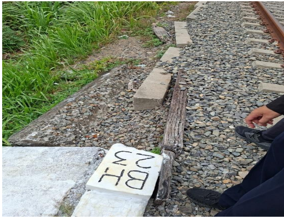
Gambar 4.10: Kondisi Balas Stoper (Sumber Dokumen Penulis)
