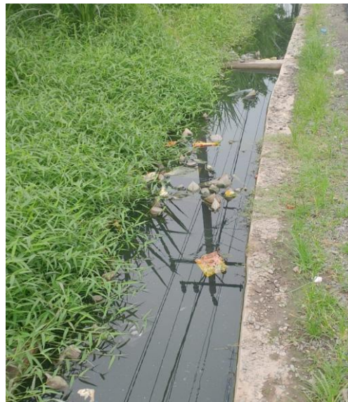
Gambar 4.5. Kondisi drainase akibat tumpukan sampah
