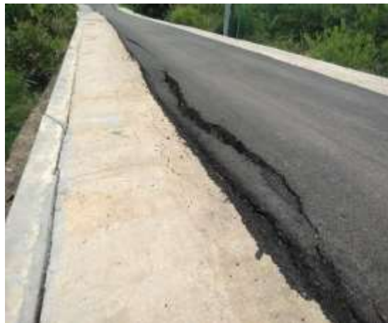
Gambar 2.14: Penurunan Jalur/Bahu Jalan
