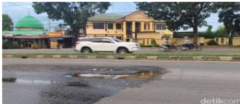
Gambar 4.1: Genangan air di Jalan Sisingamangaraja
