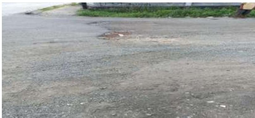
Gambar 4.2: Kondisi kerusakan aspal yang terjadi
