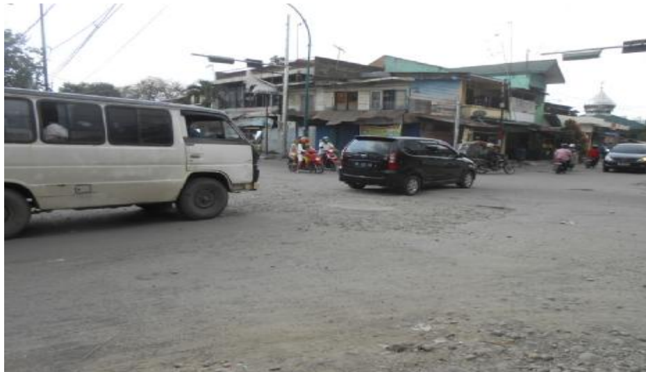
Gambar L.4: Kondisi jalan rusak.
