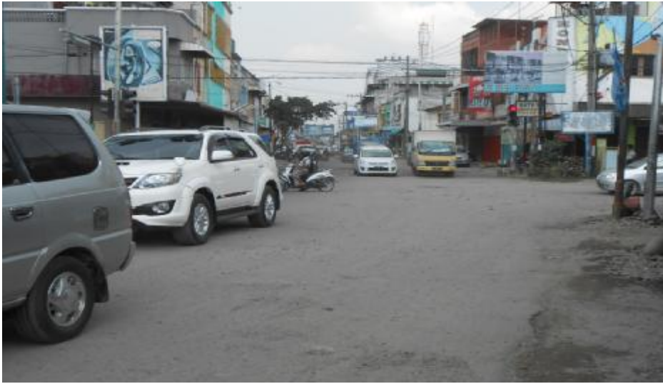
Gambar L.3: Kondisi jalan Rusak.
