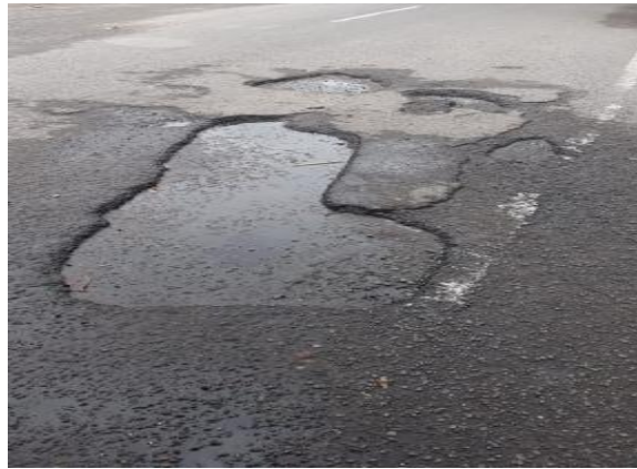
Gambar L5: Kondisi jalan rusak pada lokasi penelitian (1)
