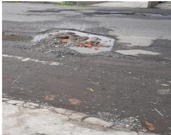
Gambar L6: Kondisi jalan rusak pada lokasi penelitian (2)
