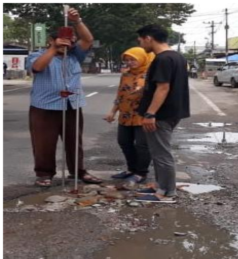
Gambar L3: Pengujian nilai CBR tanah menggunakan DCP pada aspal yang rusak
