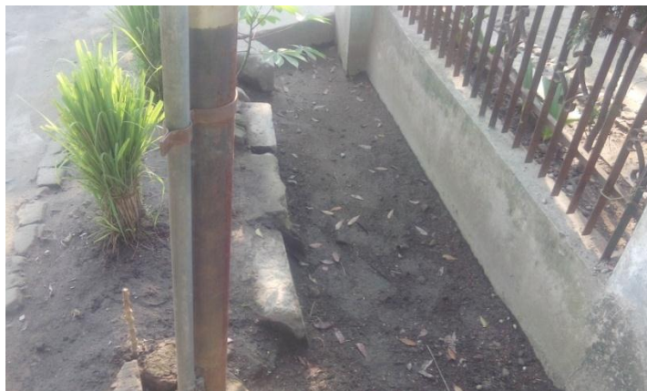
Gambar 3.4: Drainase kiri jalan Helvetia raya tertutup sedimentasi
