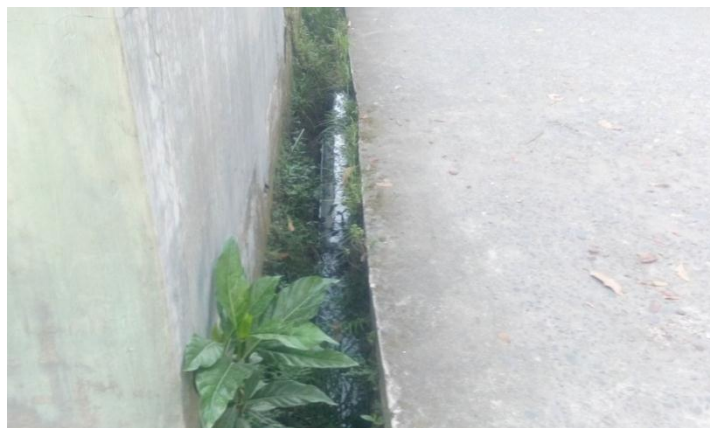
Gambar 3.5: Drainase pada jalan Mawar 4 tertutup vegetasi
