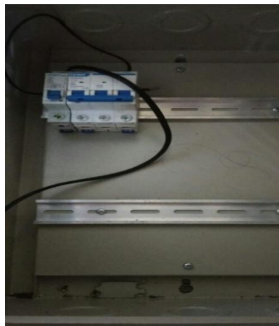
Gambar 4.11 Hasil Pemasangan MCB 1phase dan MCB 3phase
