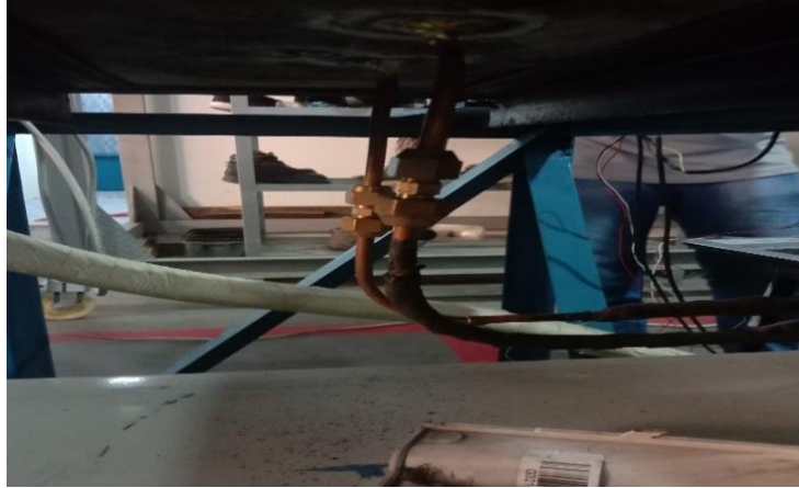
Gambar 4.9 Pipa keluaran kompresor
