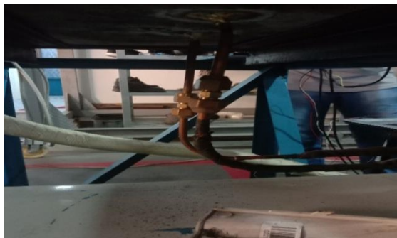
Gambar 3.2.34 Pipa masuk kondensor
