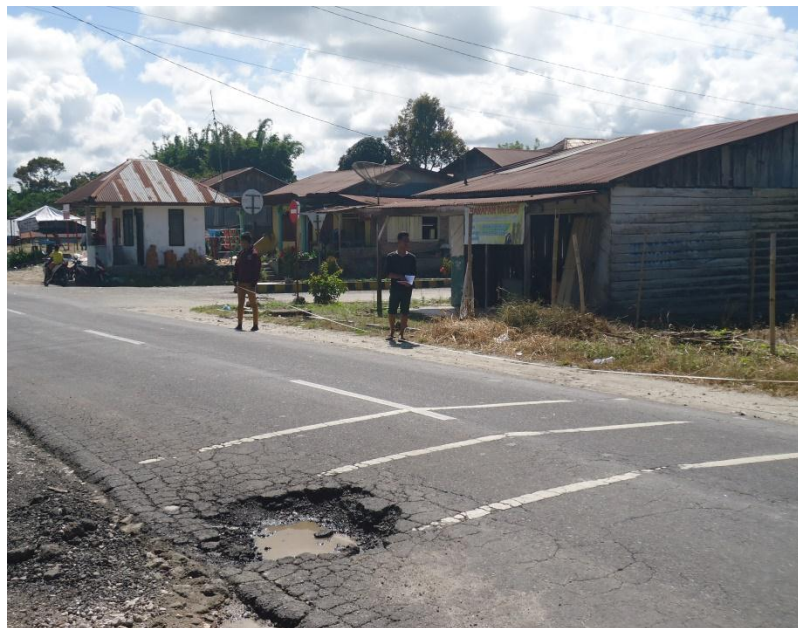
Gambar L 2: Jalan Lintas Barat Sumatera Utara Sitinjo-Sidikalang STA 00+000 – 02+000 yang tidak baik atau rusak.
