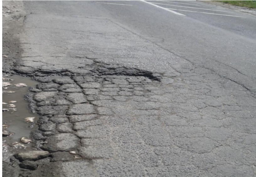
Gambar L 1: Jalan Lintas Barat Sumatera Utara sitinjo-sidikalang STA 00+000 – 02+000 yang tidak baik atau rusak.
