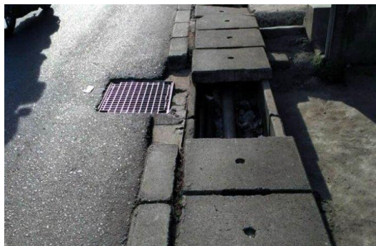
Gambar 2.3 Saluran Drainase Permukaan Tanah.
