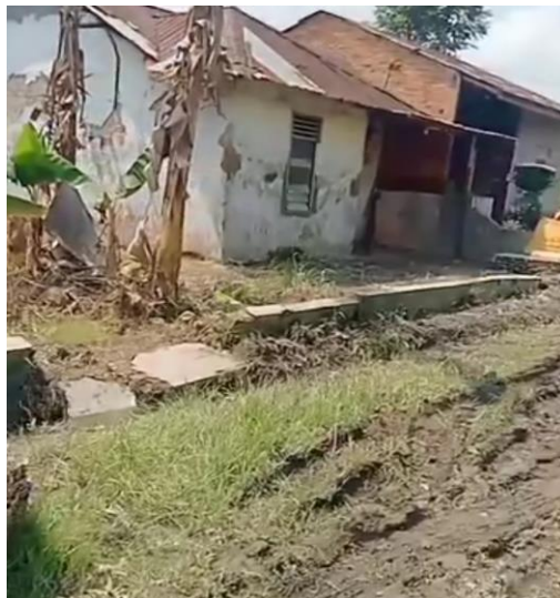
Gambar 4.1 Gambar Kerusakan Dinding Rumah
