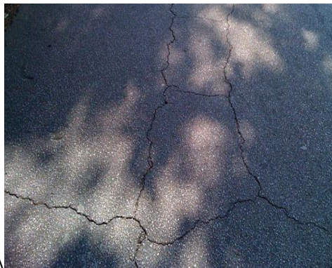
Gambar 2.6 Retak Blok (Bina Marga,1983).
