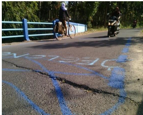
Gambar 2.11 Retak Sambung (Bina Marga,1983).
