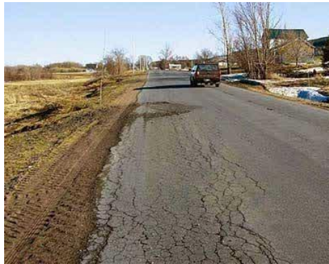
Gambar 2.10 Retak Pinggir (Bina Marga, 1983).
