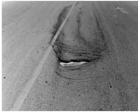
Gambar 2.20 Retak Slip ( Bina Marga,1983 ).
