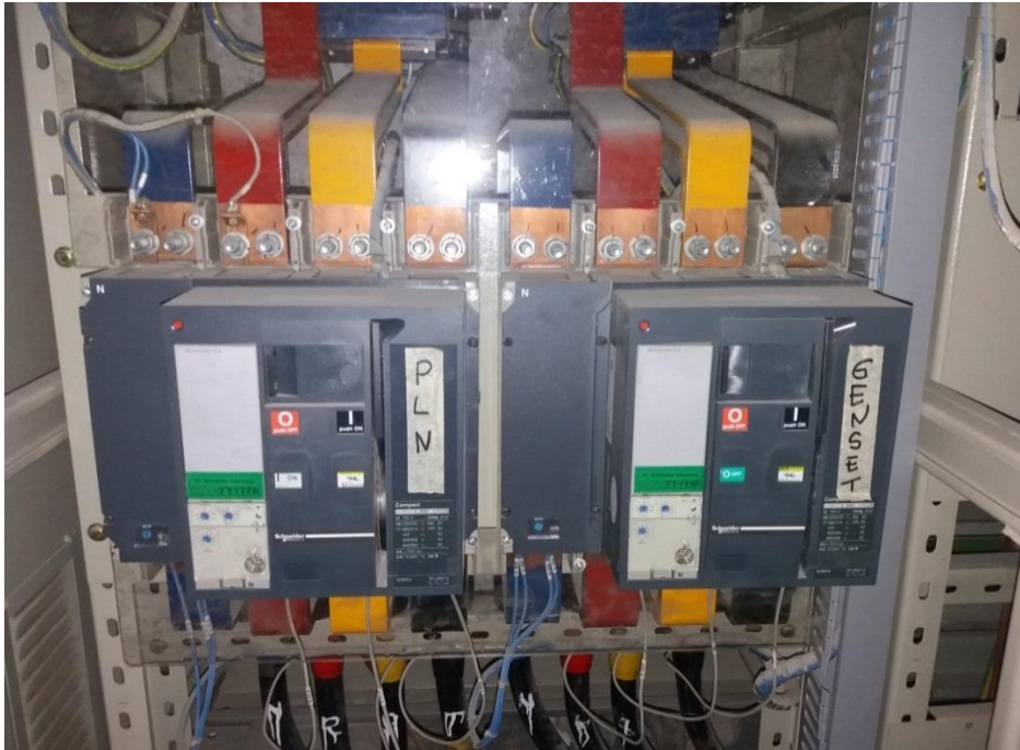
Gambar 2.11 MCCB NS1250 pada panel LVMDP Saka Premiere Hotel
