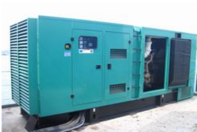
Gambar 2.5 Diesel Generator pada Saka Premiere Hotel
