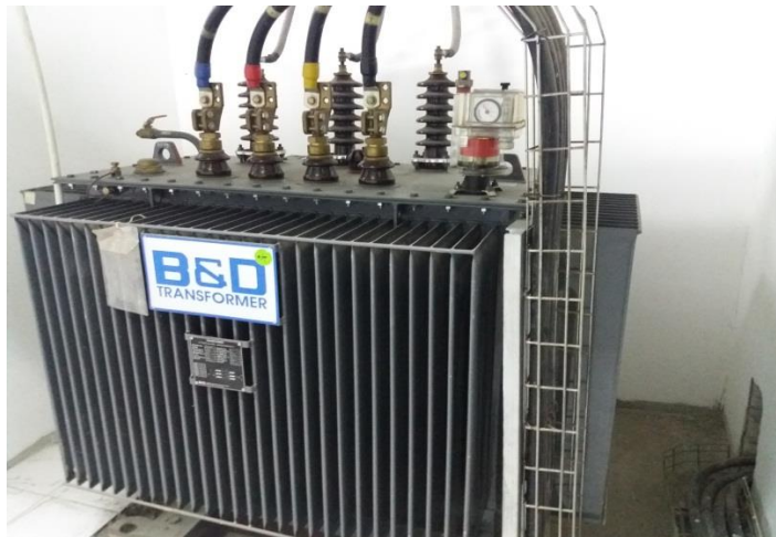
Gambar 2.4 Trafo daya 555 kVA pada Saka Premiere Hotel
