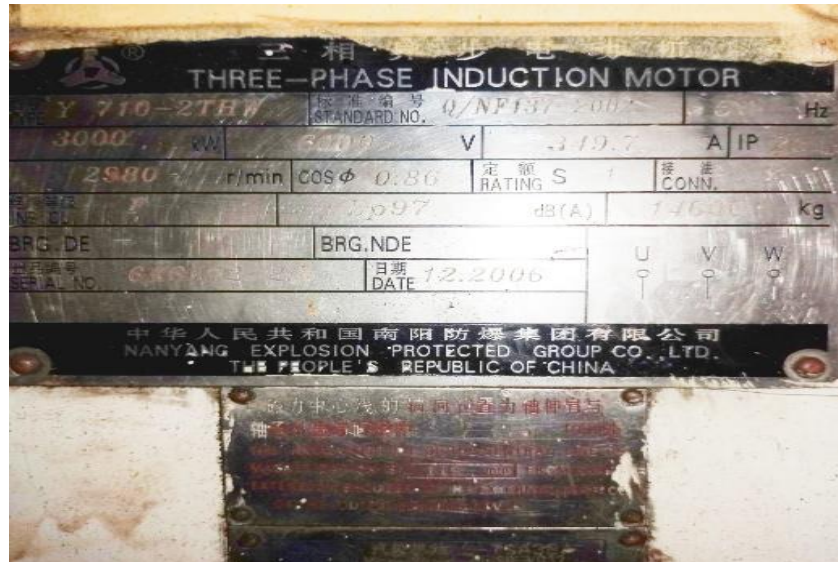
Gambar 4.10 Namplate Motor 6 Kv di BFWP PLTU LBA
