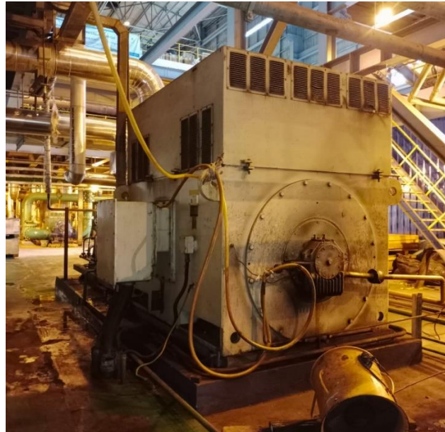
Gambar 4.2 Motor 6 kv BFWP PLTU Labuhan Angin
