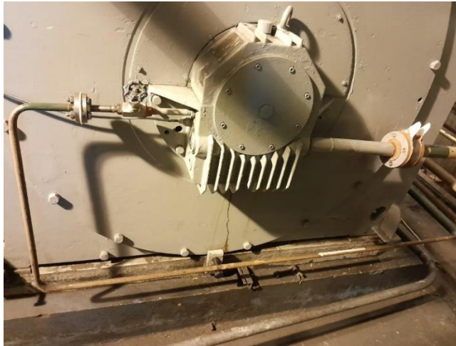
Gambar 4.5 Tempat Penyaluran Oli ke Bearing Motor 6 kV
