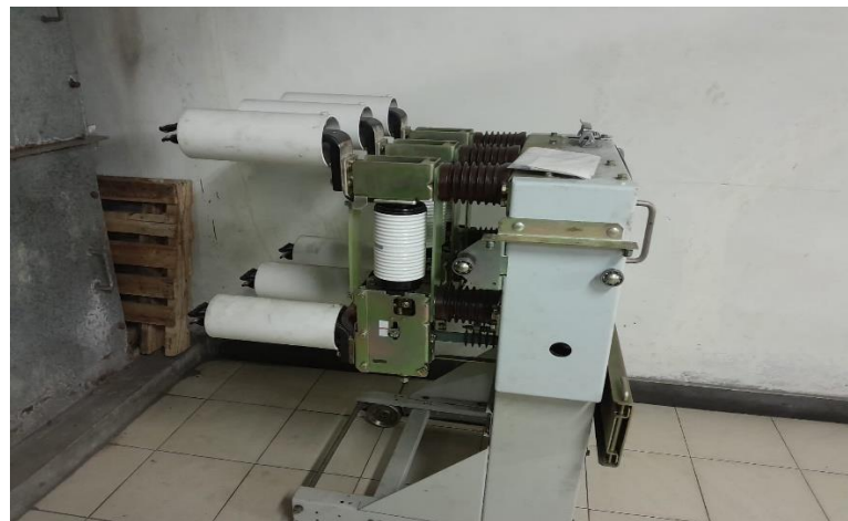
Gambar 4.8 Breaker dalam Panel
