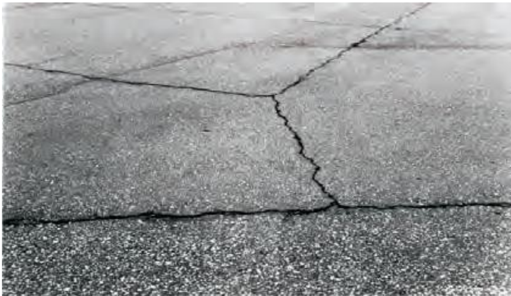
Gambar 2.3: Retak Kotak Kotak ( Block Cracking ) Sumber: https://e-journal.uajy.ac.id/11489/3/TS143792.pdf
