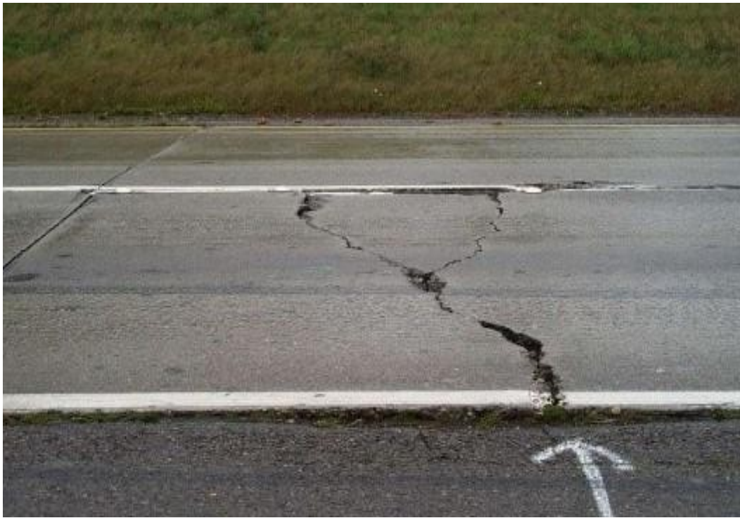
Gambar 2.10 Retak Memanjang/Melintang ( Longitudinal/Transverse Cracking ) Sumber : https://dpu.kulonprogokab.go.id/detil/61/jenis-kerusakan-jalan-pada-perkerasan-lentur
