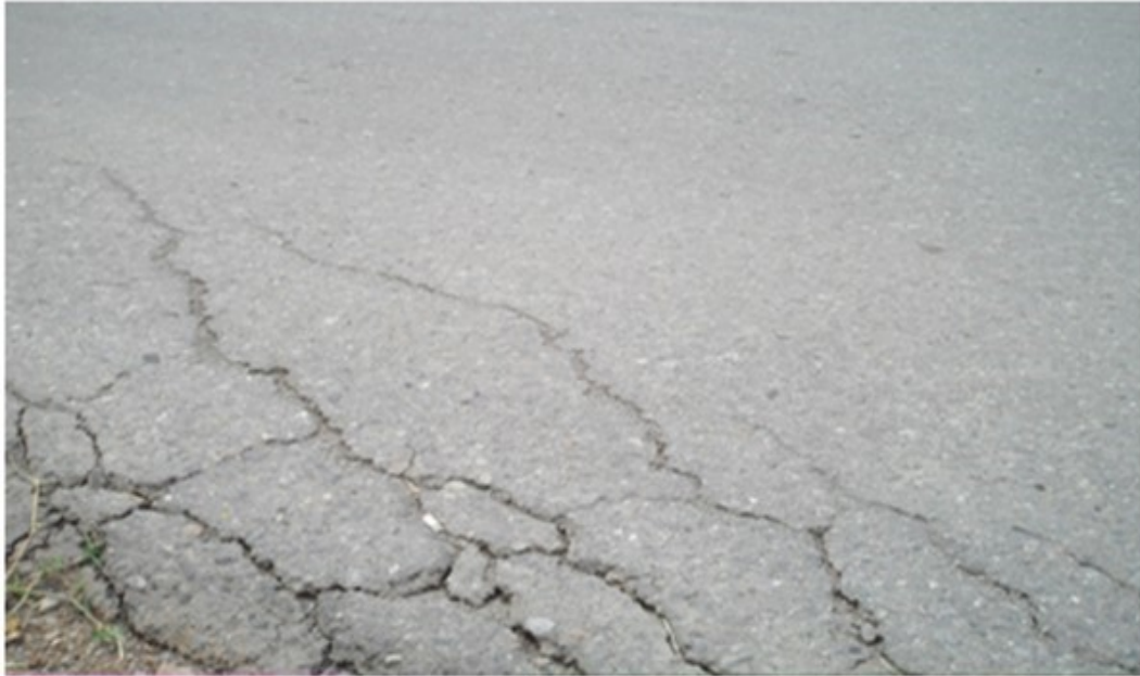
Gambar 2.7: Retak Pinggir ( Edge Cracking ).
