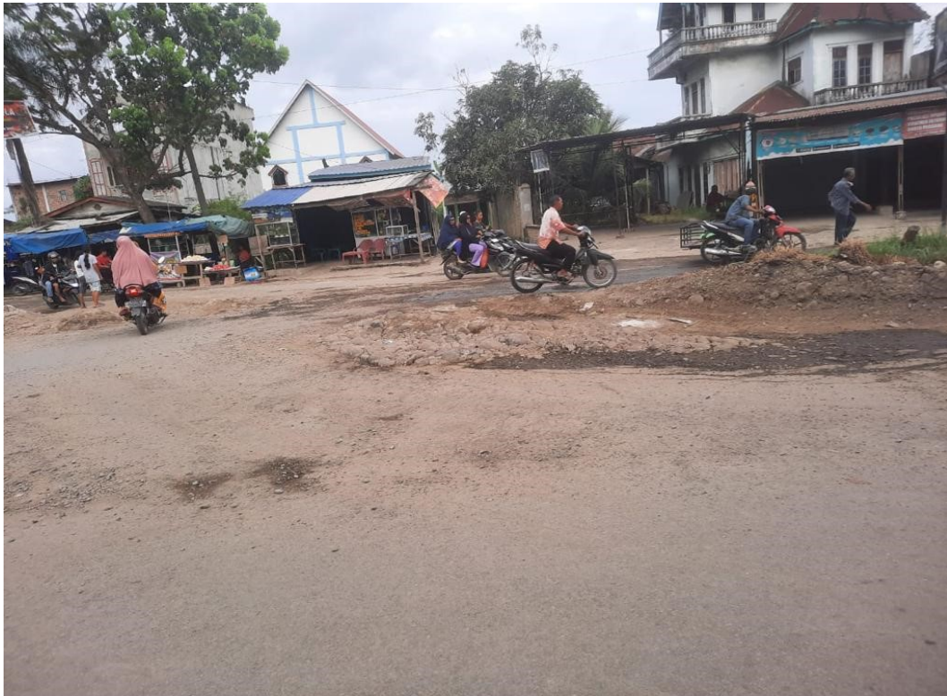
Gambar 4.1: Kondisi jalan rawe I Kecamatan Medan Labuhan
