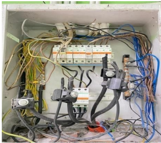
Gambar 2.33 Panel Pembagi PLTS & PLN
