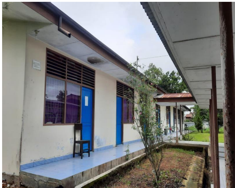
Gambar L.2 : Kondisi Asrama Poltekes Kabanjahe
