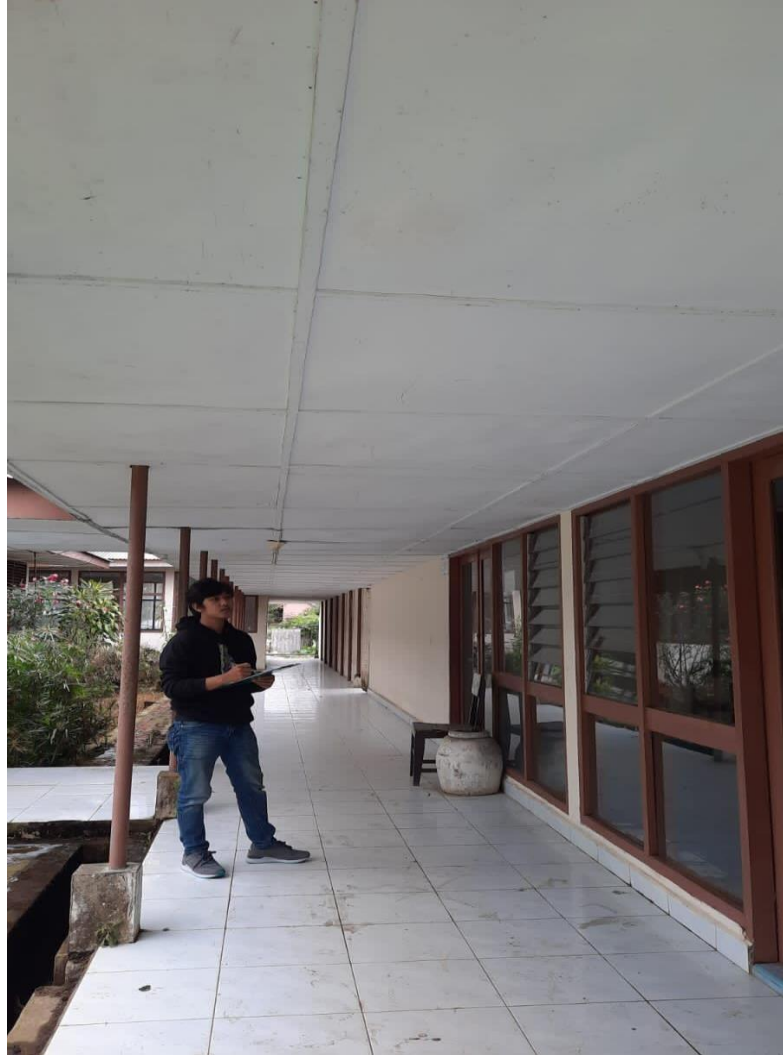
Gambar L.3 : Kondisi Asrama Poltekes Kabanjahe
