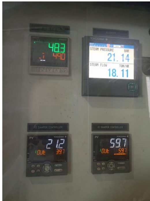
Gambar 3.8 Panel Parameter boiler
