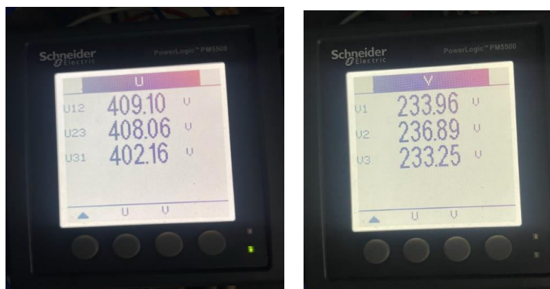
Gambar 4.9 Tampilan Parameter Tegangan pada Power Meter
