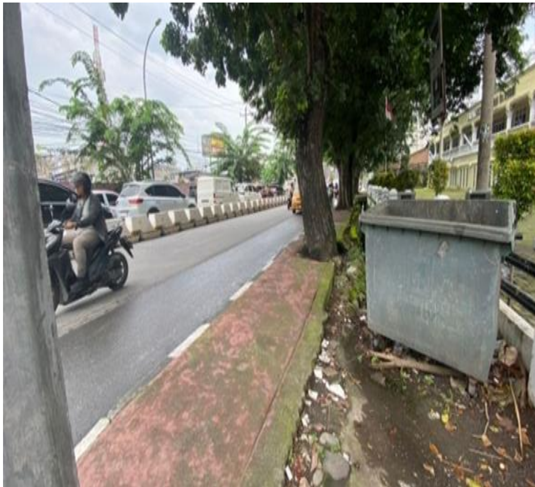
Gambar 3.3 : Kondisi Jalur Pedestrian
