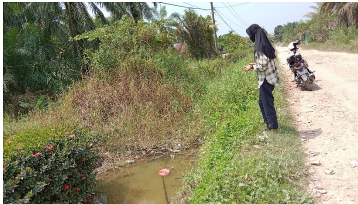
Gambar 2. Drainase Penuh Sampah Dan Semak Sebelum Banjir
