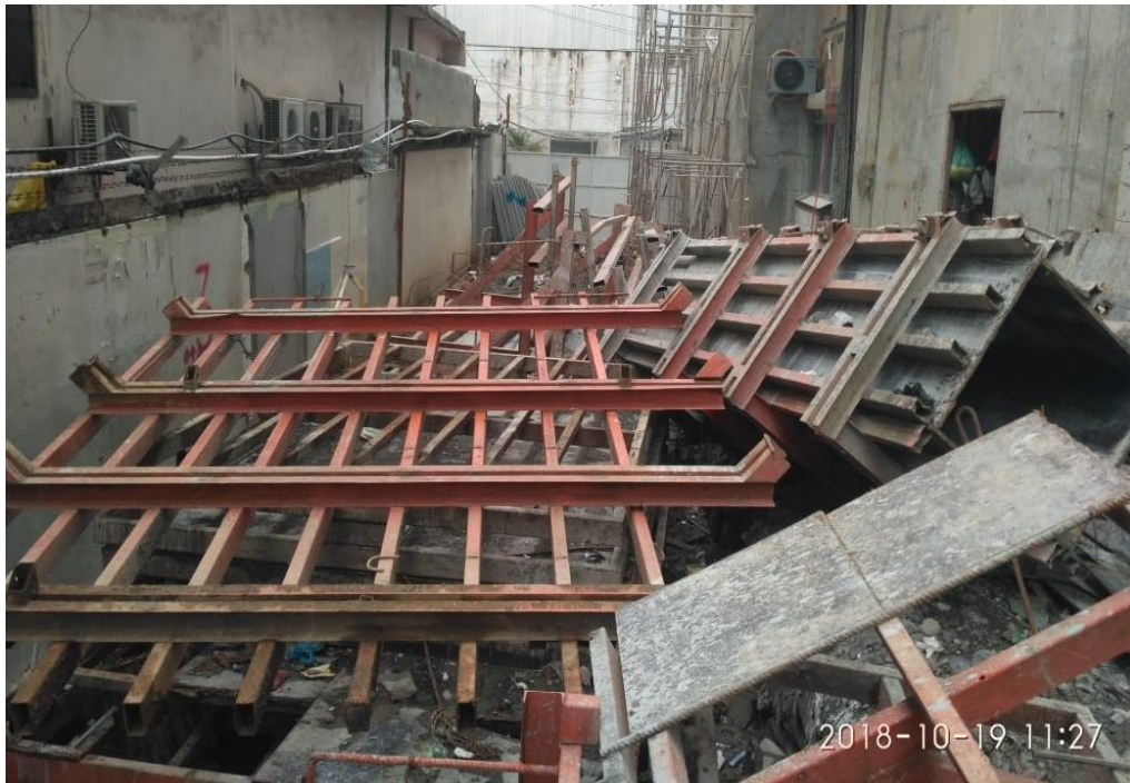
Bekisting Phenolic Yang Sudah Mencapai Batas Pemakaian
