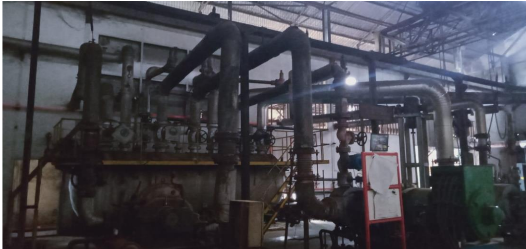
Turbun Uap No. 4 Kapasitas 1400 KVA
