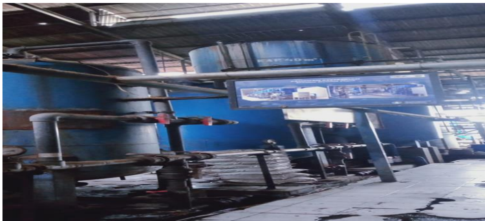
Gambar 2.10.3.2. Stasiun Demin Plant
