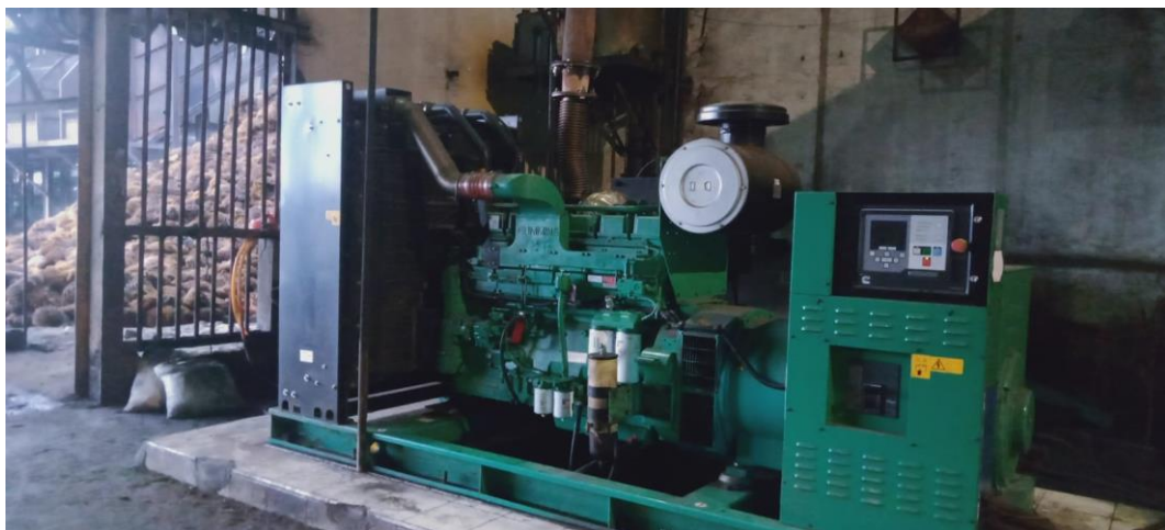
Diesel Kapasitas 350 KVA
