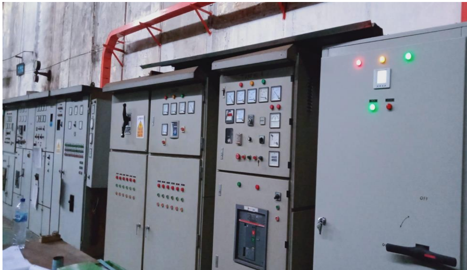
Gambar 2.10.2.3. Panel Utama Kamar Mesin
