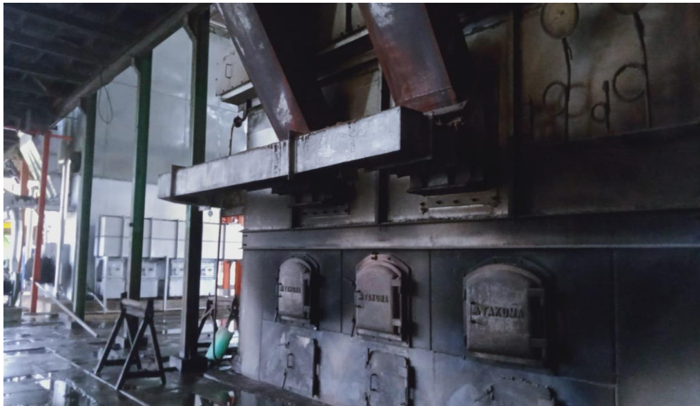
Gambar 2.10.1. Ruang Bahan Bakar Boiler Pada Stasiun Boiler
