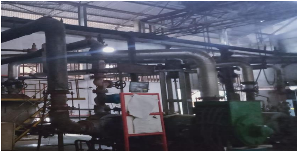
Gambar 2.10.2.1. Turbin Uap No.4 Kapasitas 1400 KVA
