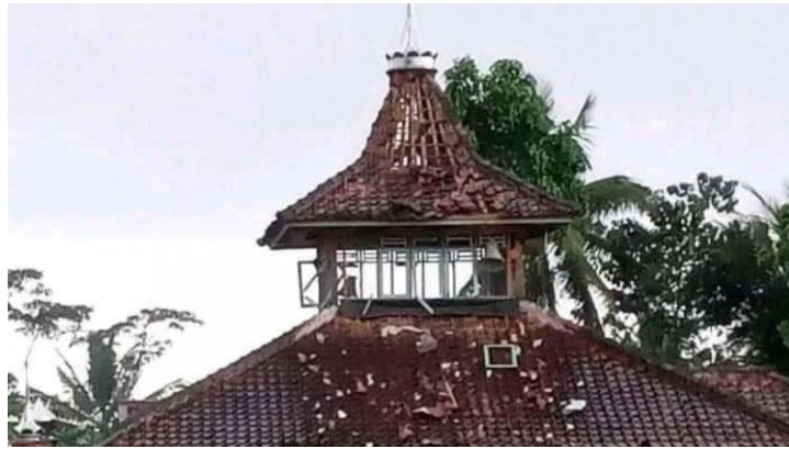
Gambar 2.8 Kerusakan Bangunan Akibat Sambaran Petir
