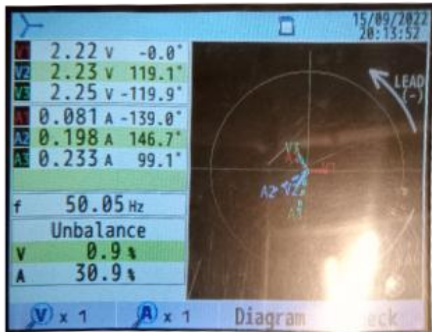
Gambar 4. 7 : Pengukuran Pada Panel Pembagi Beban Normal
