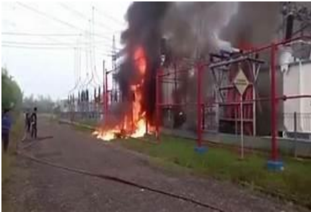
Gambar 1.1. Transformator PLTG Jakabaring meledak dan terbakar [30]
