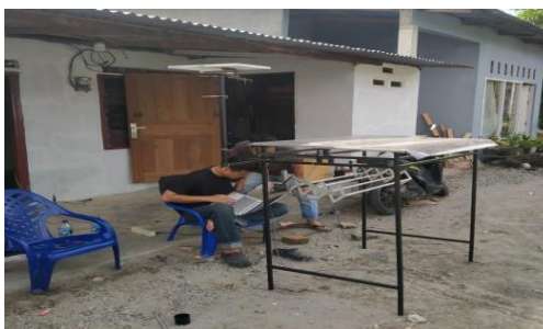
Gambar 3.34 Pengujian langsung panel surya ke ruangan terbuka supaya bisa langsung terkena cahaya matahari
