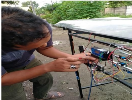
Gambar 3.28 Pemasangan Kabel Dari Panel Surya ke Dudukan Penjepit Baut Yang Ada Di Solar Charger Controller
