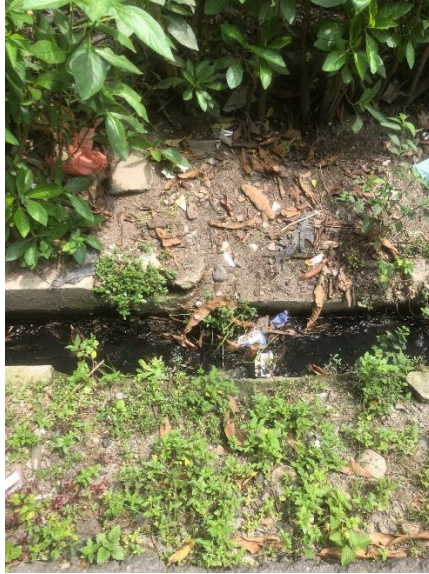
Gambar L-3: Kerusakan pada saluran eksisting
