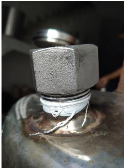
Gambar 4.14 pipa air masuk.
