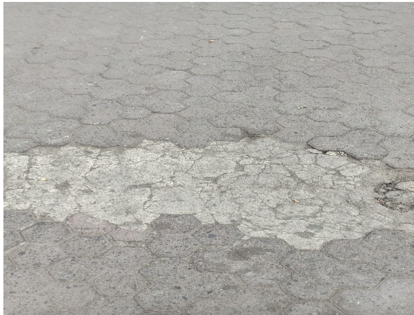
Gambar 4.6: Kondisi jalur pedestrian.
