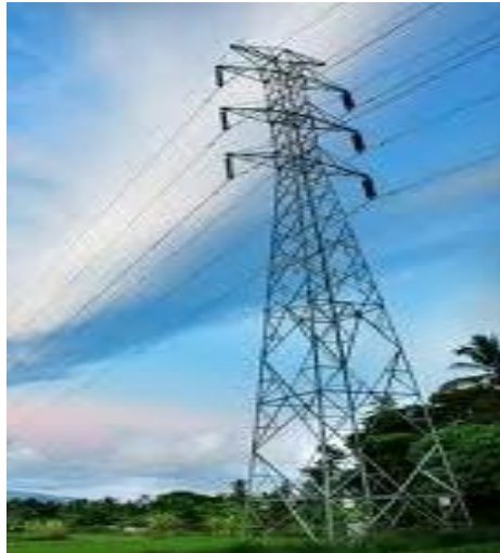
Gambar 2.2 Saluran Udara Tegangan Tinggi
