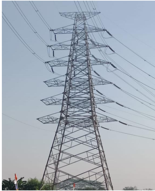
Gambar 2.4 Menara Transmisi 500 kV
