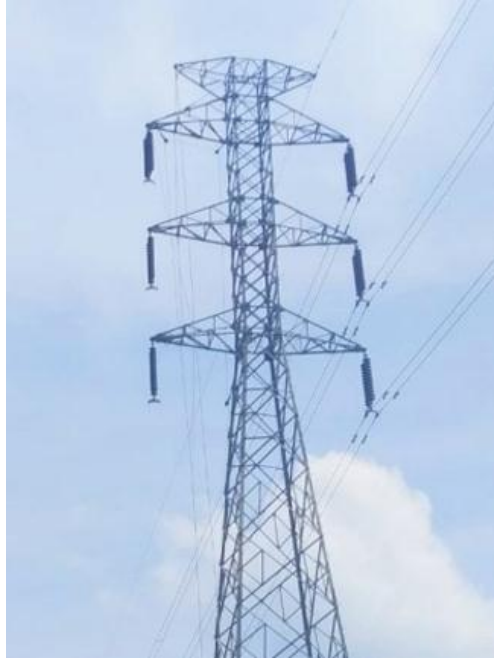
Gambar 2.5 Menara Transmisi 150 kV
