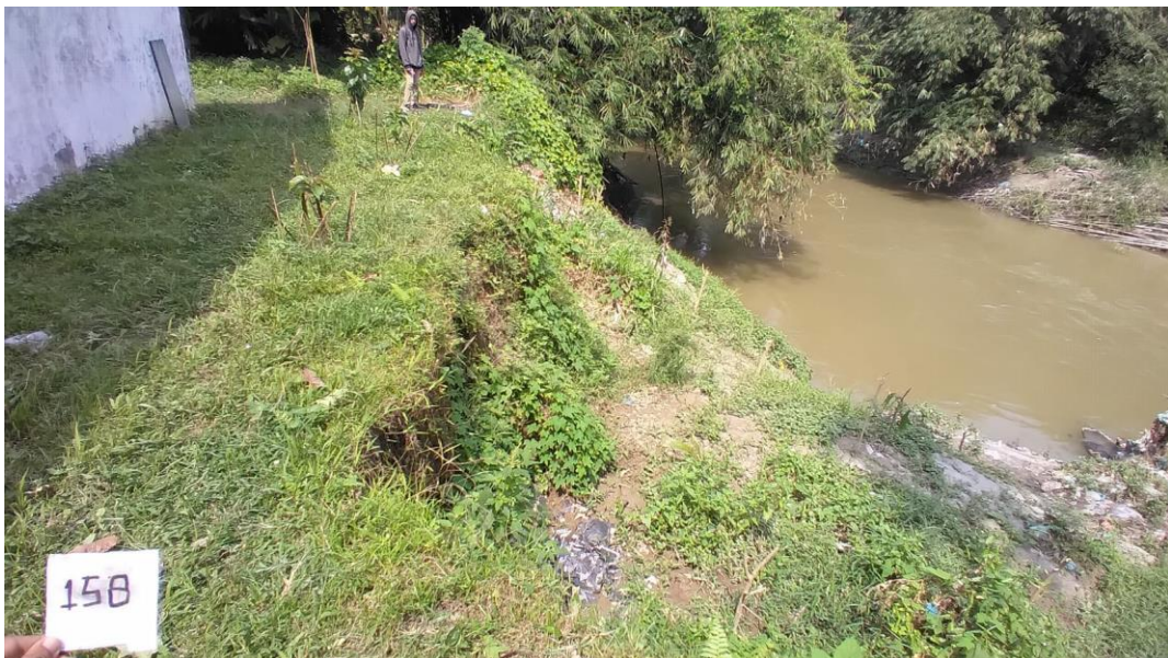
Gambar 4.2: Kondisi longsor pada sungai
