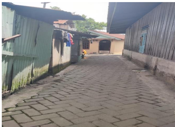
Gambar 3.6: Lokasi Rentan Banjir Dijalan Pemukiman Warga
