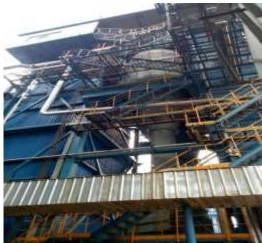
Gambar 2.5. Boiler Pipa Air PT Permata Hijau Group
