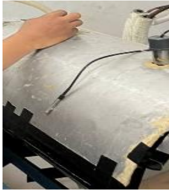
Gambar 4.19 Pemasangan Sensor Pada Tangki
