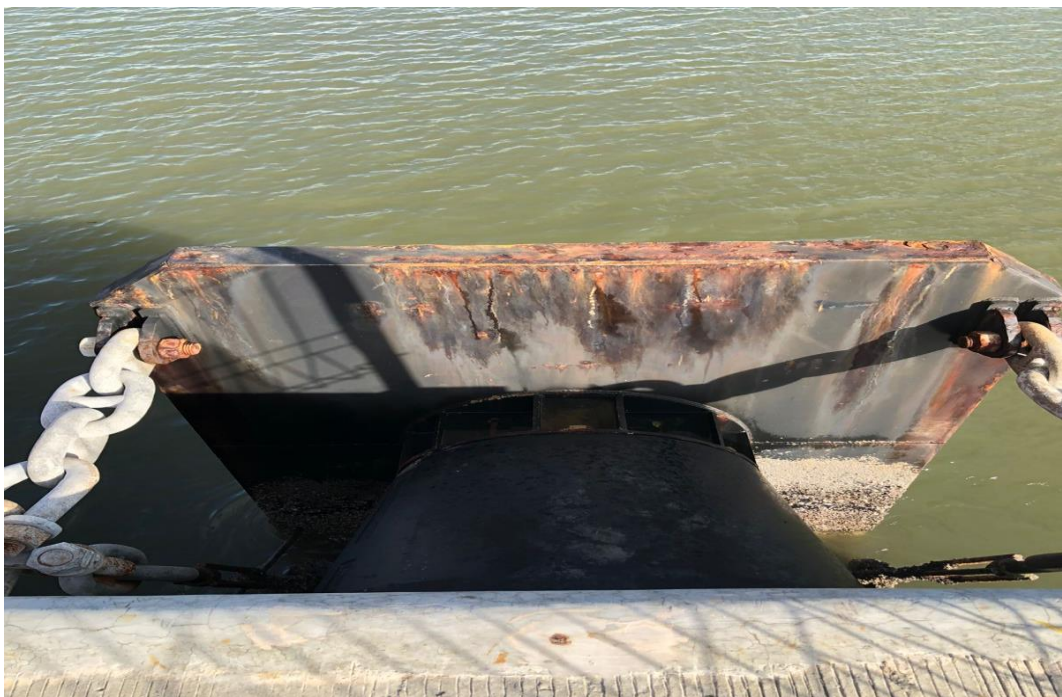
Gambar 4: fender yang ada di dermaga pelabuhan peti kemas Belawan.
