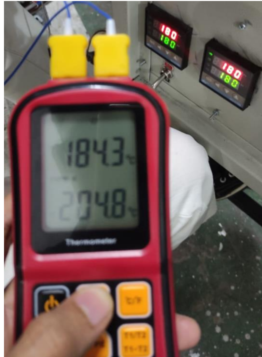
Gambar 4.36 Perbandingan suhu heater 1 dan 2
