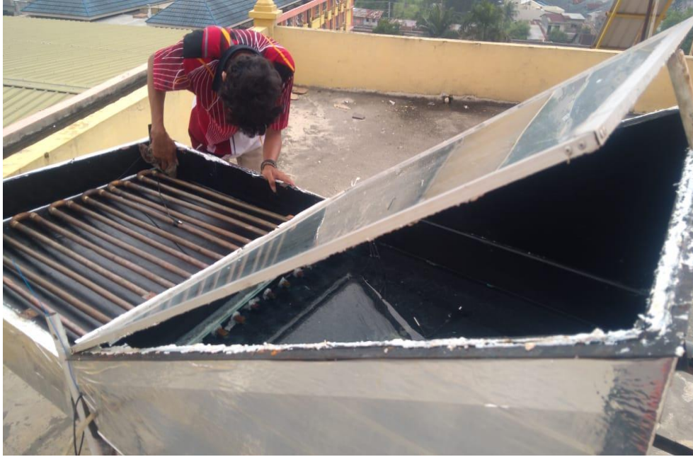
Pengecekan dan pemeriksaan alat desalinasi untuk menghindari kebocoran
