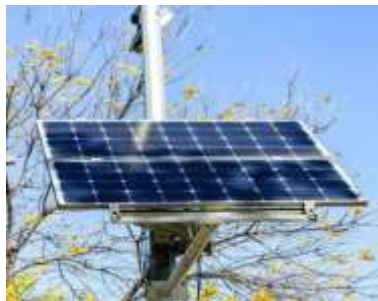
Gambar 2. 13 Pembangkit Listrik Tenaga Surya (PLTS)
