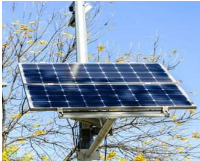
Gambar 2. 6 Pembangkit Listrik Tenaga Surya (PLTS)
