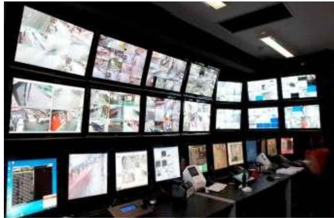
Gambar 2.11 CCTV yang telah dihubungkan
