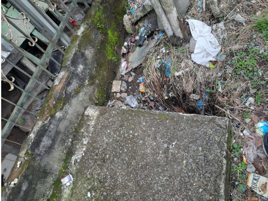
Gambar L.3: Kondisi drainase yang tidak mampu menampung debit air
