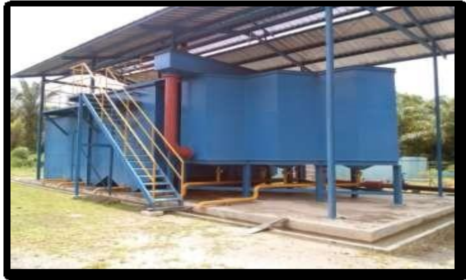
Gambar 1.7: Bak Instalasi Pengolahan Air (IPA)
