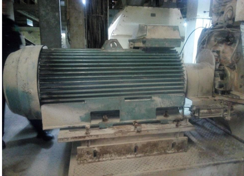
Gambar 3.1 Motor Tiga Phasa Berdaya 250 kW Yang Menggerakkan Mesin Hammermill HM 258 Yang Menjadi Objek Penelitian
