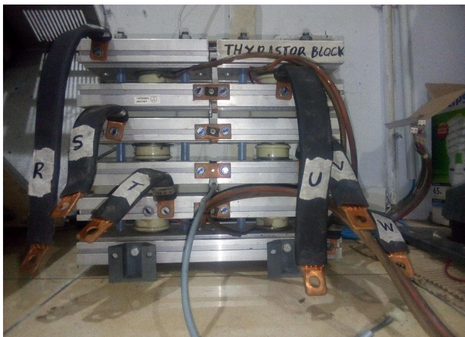
Gambar 2.14 Enam Buah Thyristor Yang Tersusun Pada Blok Aluminium Yang
