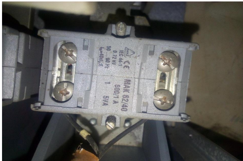
Gambar 2.17 Transformator Arus Berkapasitas 600/1 A Berdaya 5 VA Yang Terpasang Pada Salah Satu Phasa
