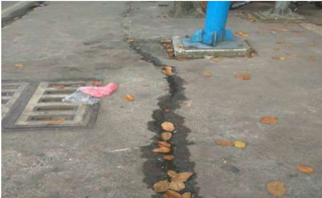
Gambar 4.6: kondisi jalur pedestrian
