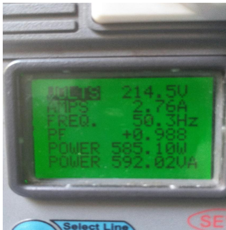
Gambar 4.4 Hasil Pengukuran Setelah Pemasangan Kapasitor Bank 12 \mu f Pada Lemari Pendingin
