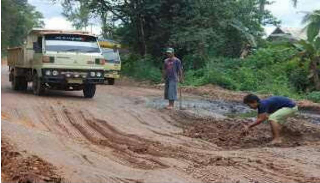
Gambar L4 a: kerusakan jalan.
