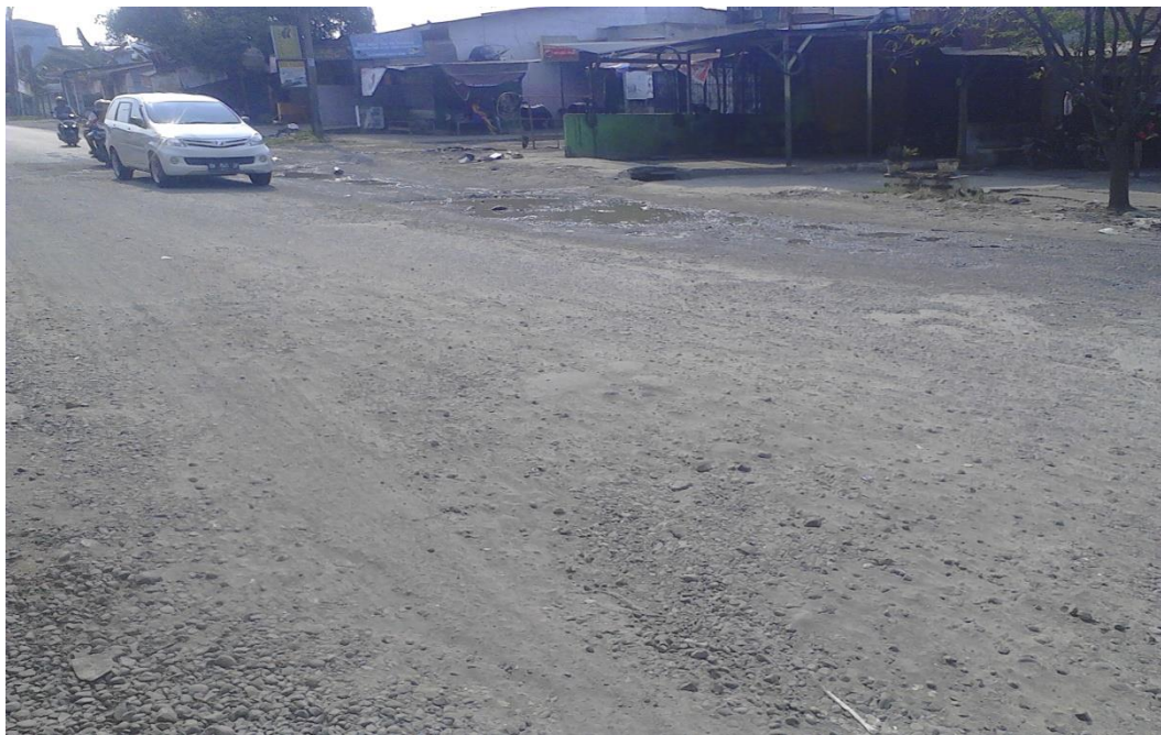
Gambar L4 b: Kerusakan jalan.
