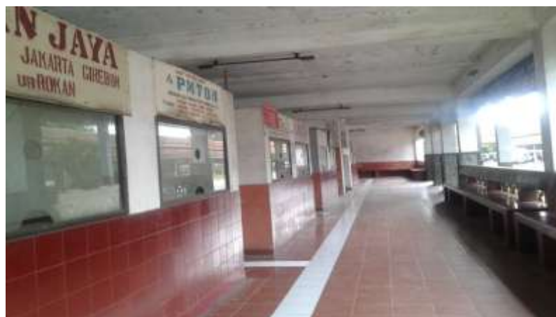
Gambar L.3: Loket karcis yang tidak berfungsi.
