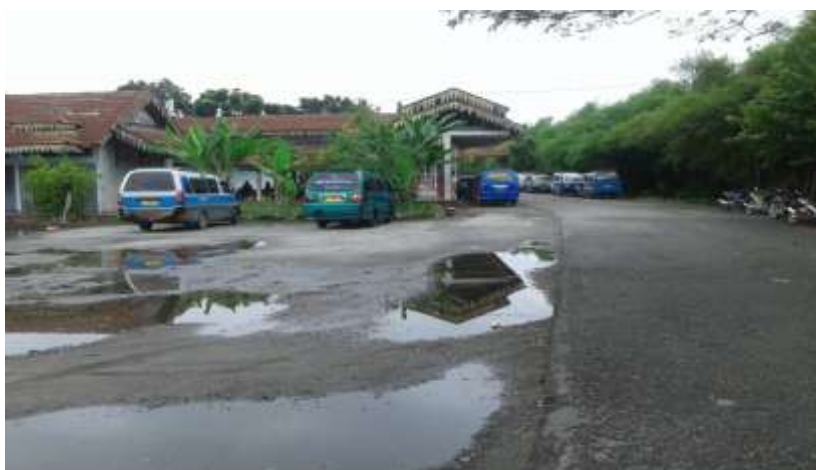
Gambar L.4: Jalan dalam terminal yang rusak menyebabkan genangan air.
