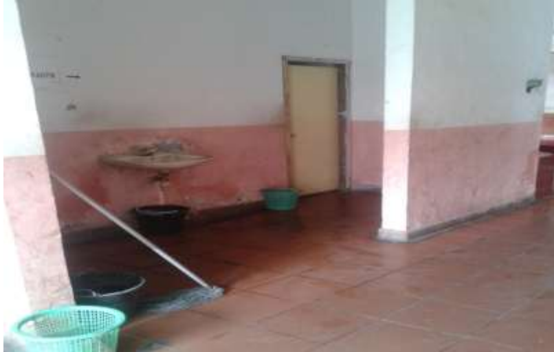
Gambar L.9: Fasilitas toilet di terminal.
