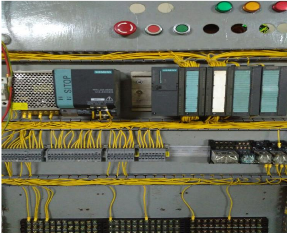
Gambar 4.4 Rangkaian PLC Siemens S7-300
